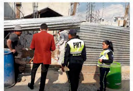
Verificación de obras sin autorización municipal que obstaculizan la vía pública con material de construcción
