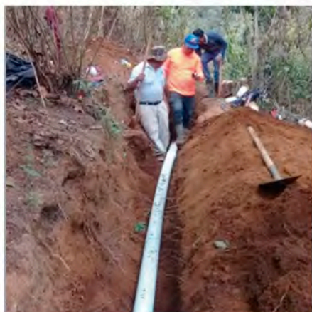
Cambio de la tubería de impulsión del pozo mecánico de agua de Chirijnimajuyub
