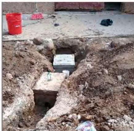
Cambio de red de la cobertura de agua en las instalaciones del Rastro Municipal.
